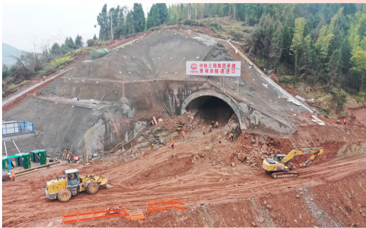
中铁3局渝万高铁站前工程3标薄荷田隧道进口进入进洞施工阶段。
