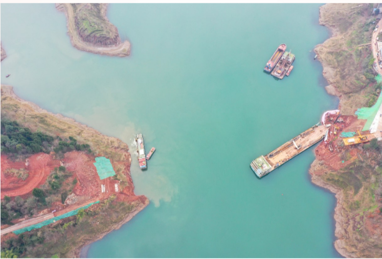
中铁18局渝万高铁站前工程2标曾井河双线特大桥施工抓紧进行。
