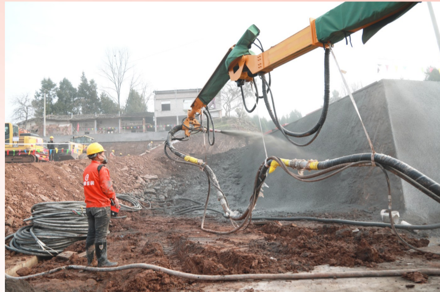
中铁11局渝万高铁站前工程1标苏家坪隧道斜井临建工程施工进入收尾阶段。
