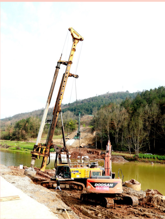
中铁18局渝万高铁站前工程2标汝溪河双线特大桥桥墩施工有序推进。
