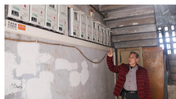
邓经乾正在检查电表箱。
